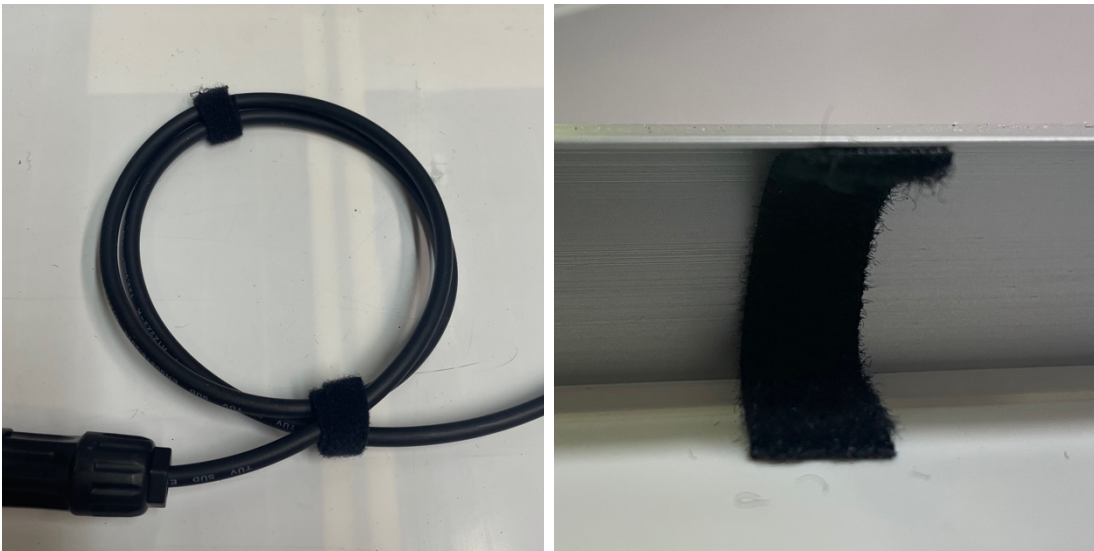
Abbildung 8: Kabelmanagement mit Klettband
