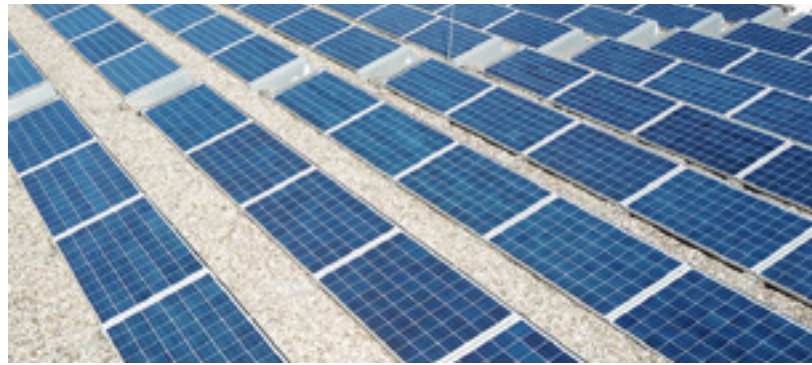
PV-Anlage auf dem Kommunikationsgebäude am Umwelt-Campus (Foto: Henrik te Heesen)
