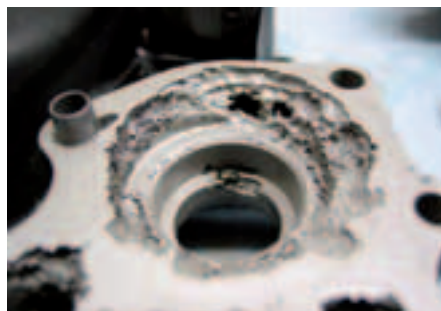
Galvanische Korrosion am Wasserpumpengehäuse
