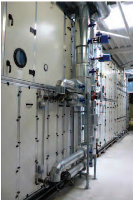
RLT-Gerät mit Wärmerückgewinnung KSB Frankenthal mit 50.000 m 3 /h
