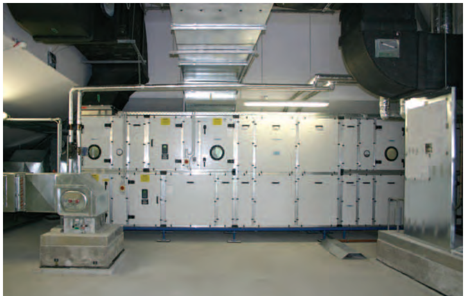
RLT-Gerät mit Wärmerückgewinnung Krankenhaus Birkenfeld mit 10.000 m 3 /h
